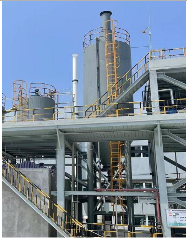
脉冲式布袋除尘器及排气筒
