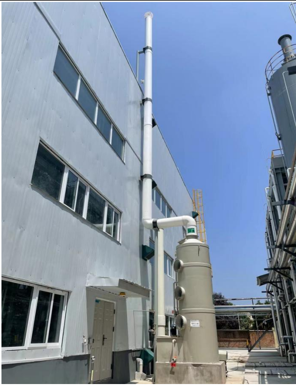
碱喷淋塔及排气筒
