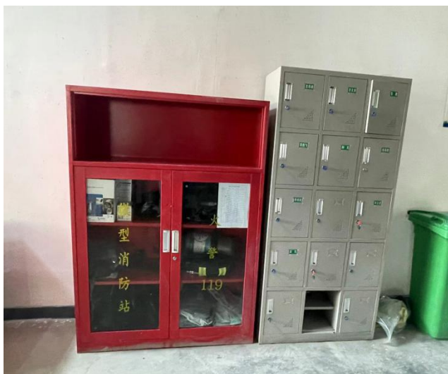
厂房内微型消防站
