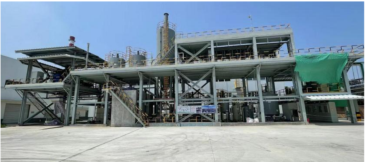
污水处理系统全貌
