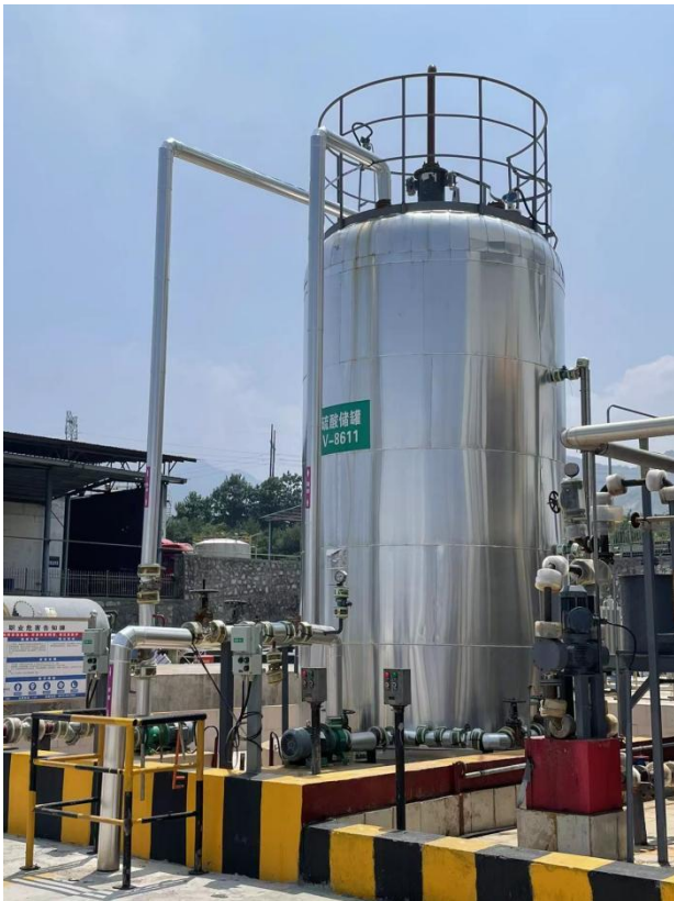
浓硫酸储罐及活性炭吸附装置
