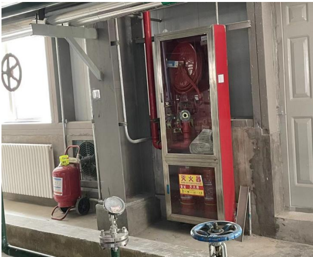
消防栓及灭火器
