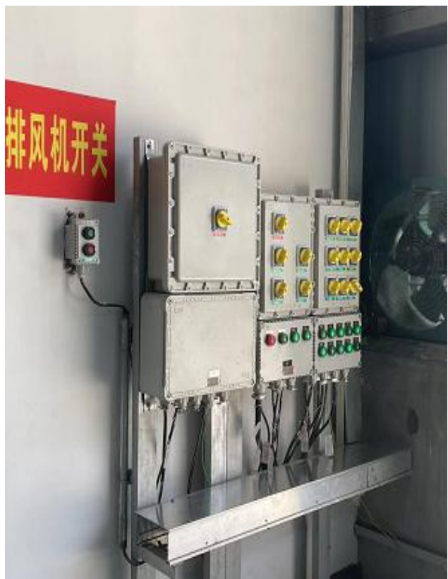
厂房内排风风机
